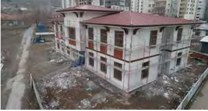
Esentepe Mahallesi Girne Şehitler Caddesi Üzerine Aile Sağlığı Merkezi Yapılması İşİ Sözleşme Bedeli : 4.976.555,44 TL
